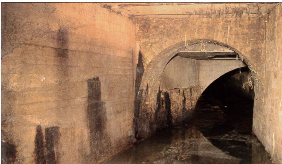
De overwelfde Ieperlee in Ieper. De oorspronkelijke rivier is de hoofdriool van de stad geworden. Verz. Lieven Stubbe.
